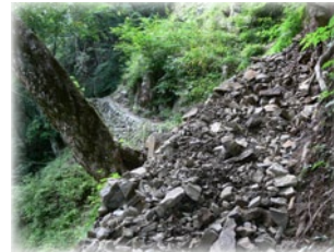
大ダワ林道崩落現場
